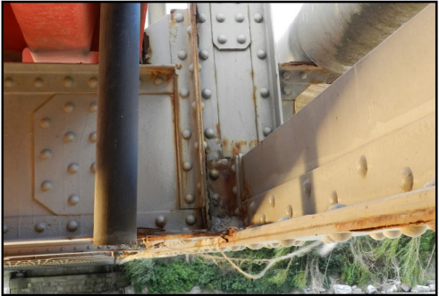
Dégâts de corrosion (Photo du relevé d'état)
